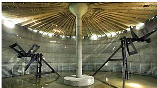
Slika 12. Unutrašnjost digestora prije puštanja u rad (Bontempo i sur., 2016).
