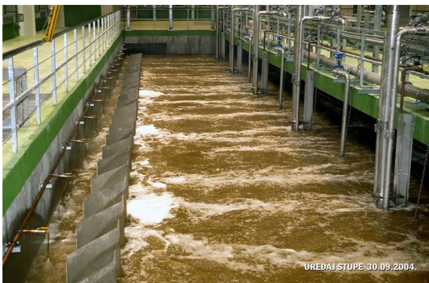
Slika 7. Uređaj za pročišćavanje otpadnih voda Stupe (Anonymous 4, 2020)
