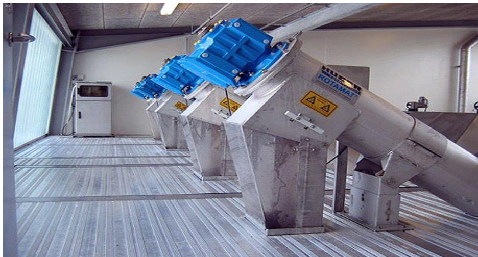
Slika 6. Fine rešetke HUBER ROTAMAT® Fine Screen Ro 1 kao polifunkcionalne jedinice u procesu obrade otpadne vode – izdvajanje, transport, pranje i sabijanje materijala (Anonymous 3, 2020)
