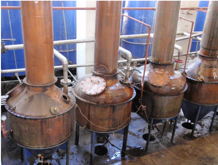
Slika 19. Bakreni kotlovi za destilaciju
