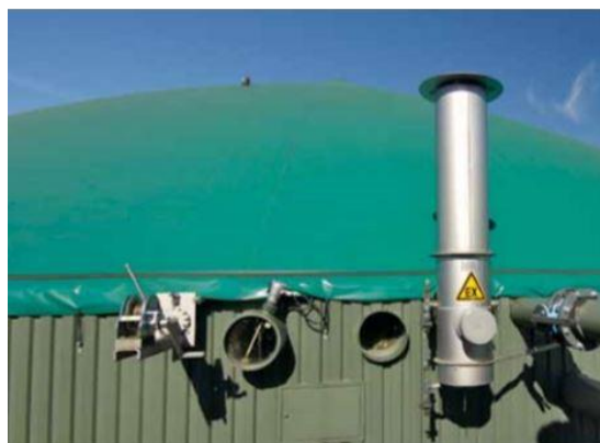
Slika 17. Sigurnosni uređaj za nadtlak i podtlak smješten na digestoru (Bontempo i sur., 2016).
