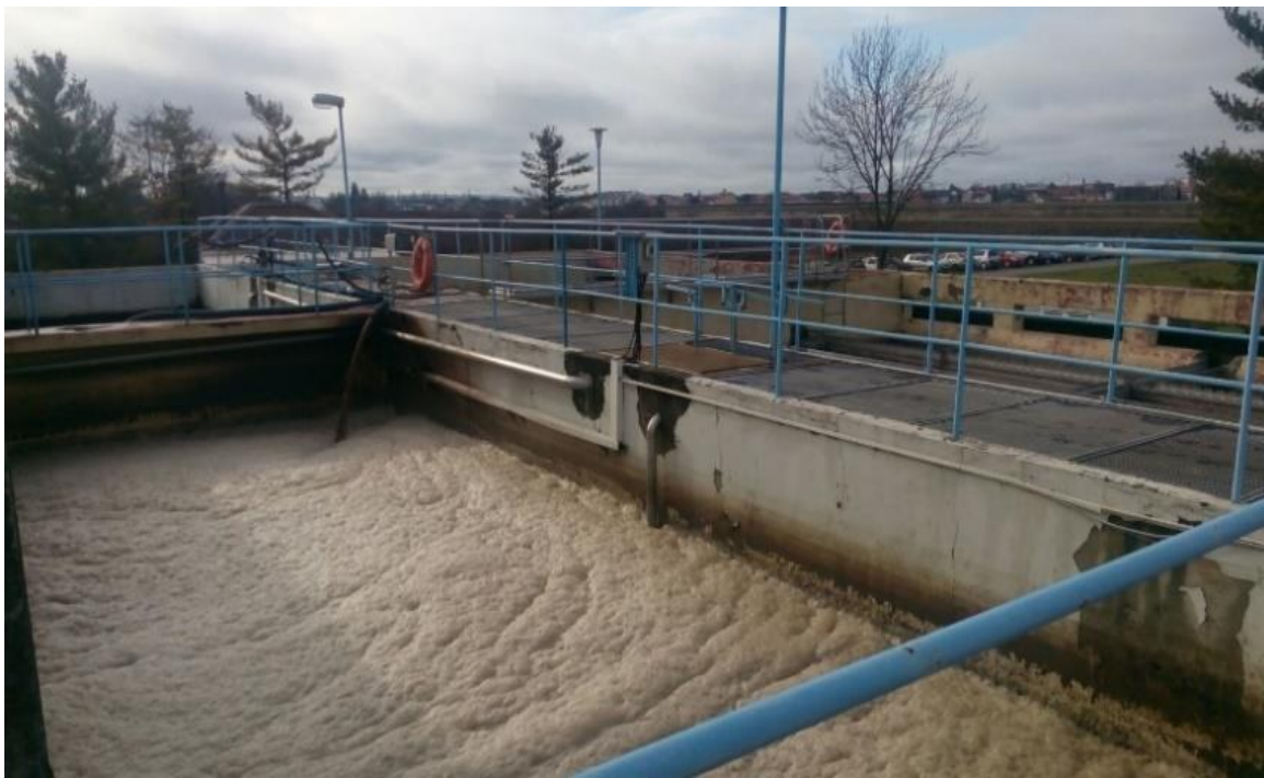
Slika 5. Uredaj za obradu otpadnih voda grada Velike Gorice (aeracijski reaktor)
