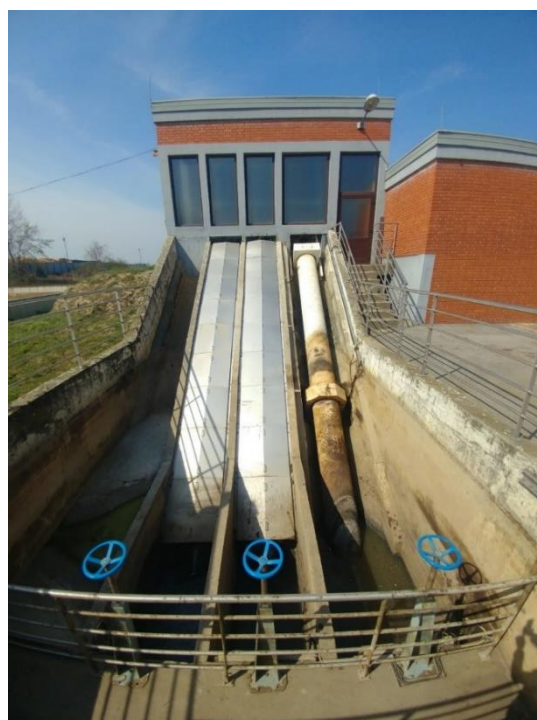
Slika 8. Ulazna crpna stanica (Anonymous, 2020).
