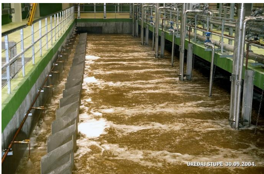
Slika 7. Uređaj za pročišćavanje otpadnih voda Stupe (Anonymous 4, 2020)
