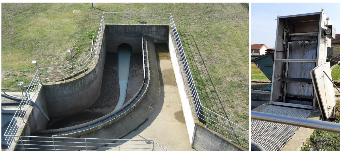
Slika 5. a) Preljevni kanal, b) automatska gruba rešetka (Anonymous, 2021)
