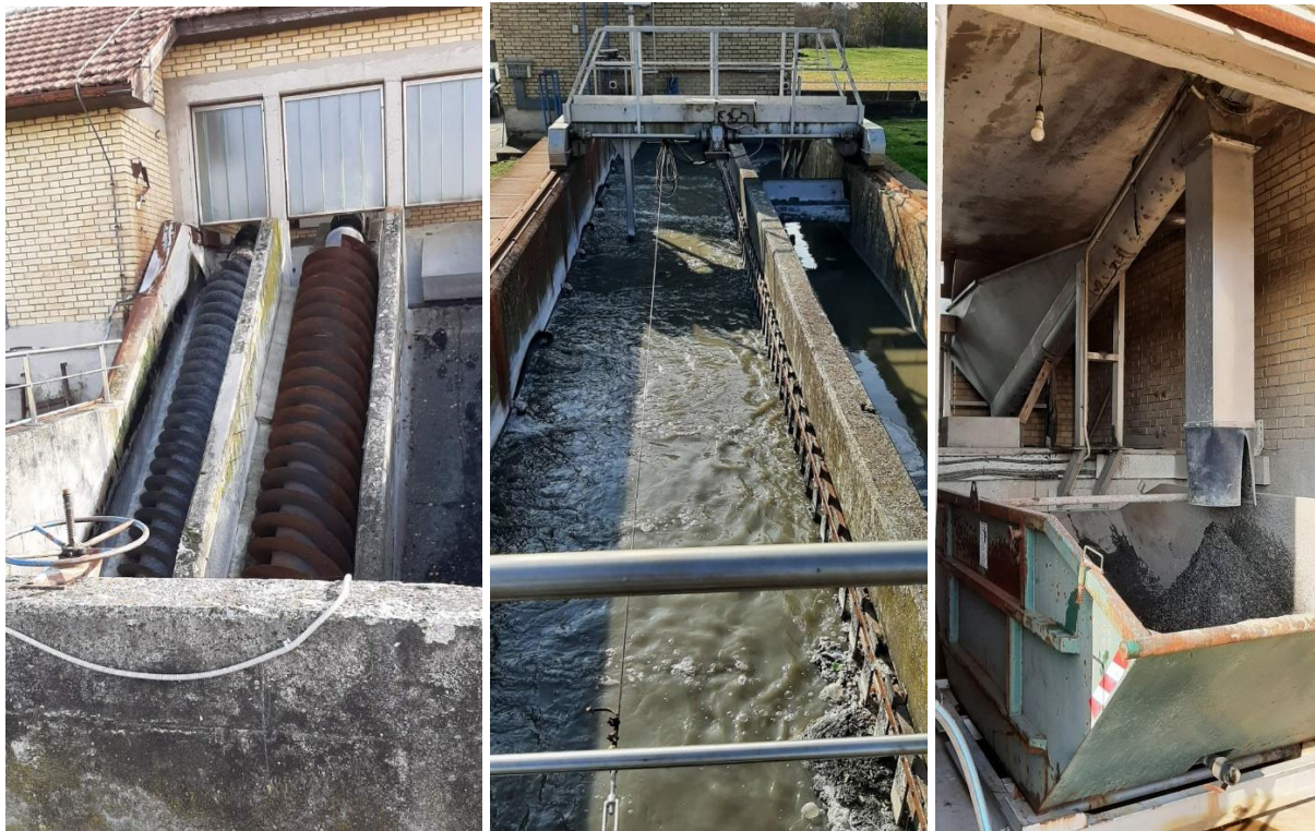
Slika 6. a) Ulazna crpna stanica s manjom i većom pužnom pumpom, b) aerirani pjeskolov - mastolov, c) separator pijeska (Anonymous, 2021)
