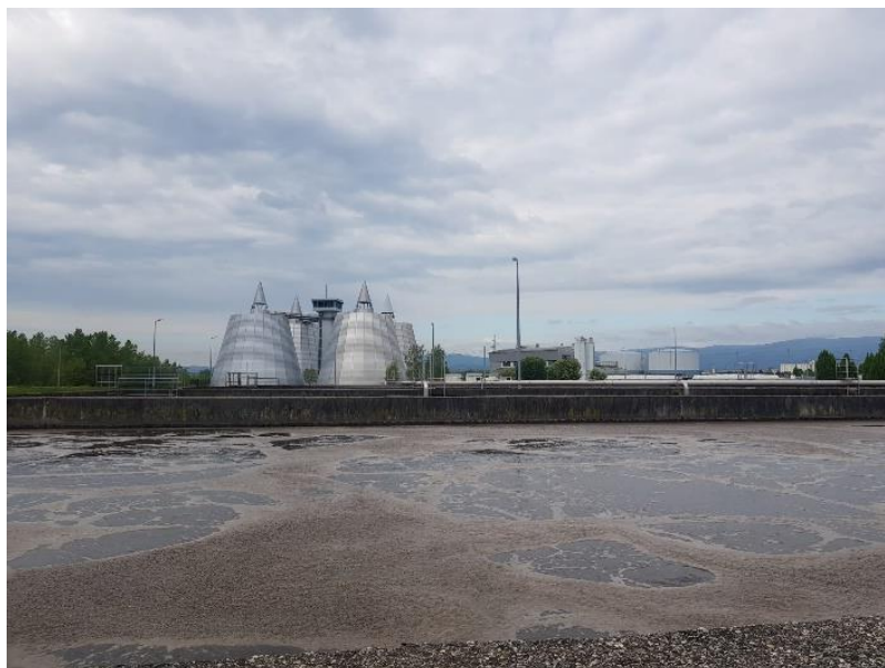
Slika 7. Bioaeracijski bazen u centralnom zagrebačkom uređaju za pročišćavanje otpadnih voda
