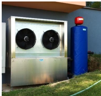
Slika 23. Rashladni sustav (Elektronovak d.o.o., 2022)
