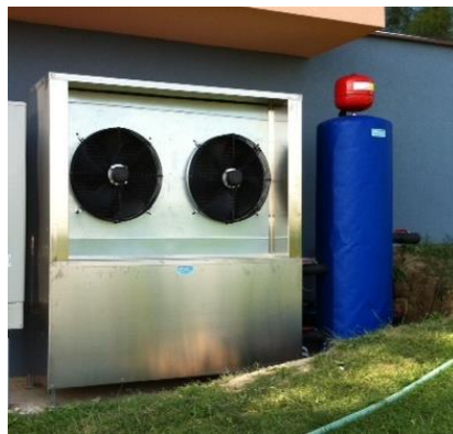
Slika 23. Rashladni sustav (Elektronovak d.o.o., 2022)
