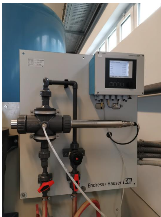
Slika 1. Sonda Memosens Wave CAS80E s kontrolerom instalirana na ulazu sirove vode u postrojenju za kondicioniranje vode Butoniga (izvor: vlastita slika)
